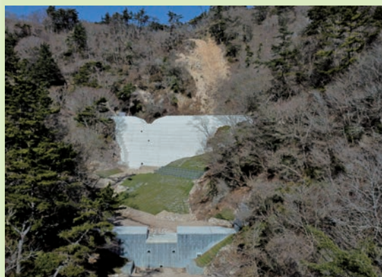
写真 治山ダムの上流に発生した崩壊
