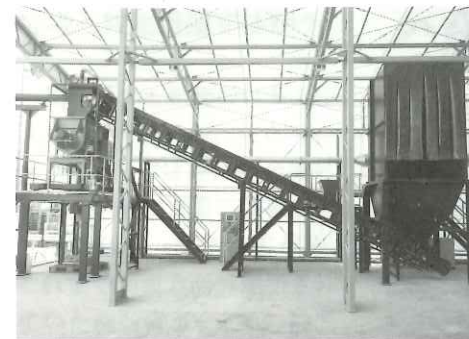
施設内にあるブレンダー装置
